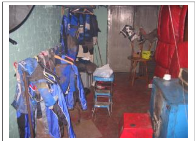
Heizungskeller des Grand Hotels (sehr nützlich)
